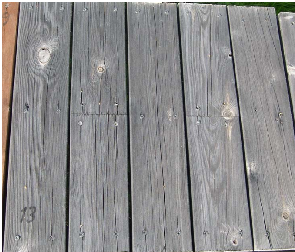
Figur 156. Eksempel på mye sprekkdannelse.
