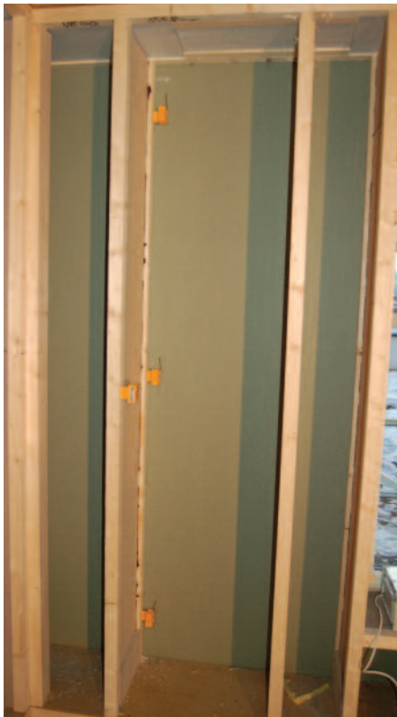
Loggere (gule) under logging av passivhus.
