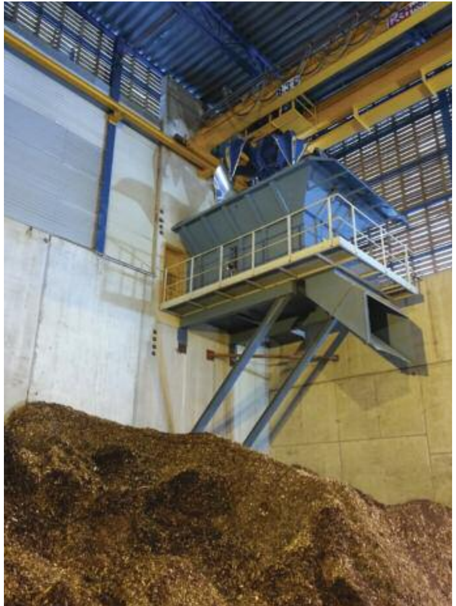
Flislageret ved Hafslund Varmesentral, Gardermoen.
