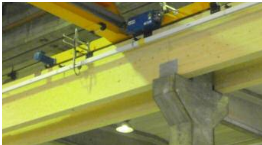
Bærebjelker for traverskran i limtre.
