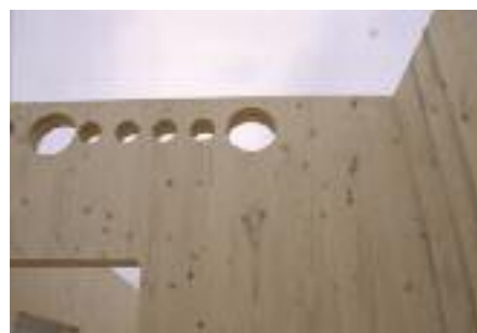
Massivtreelementene leveres med ferdige hull for tekniske installasjoner.
